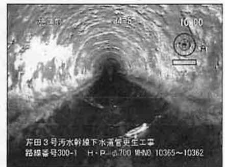
下水管の硫化水素による腐食状況
