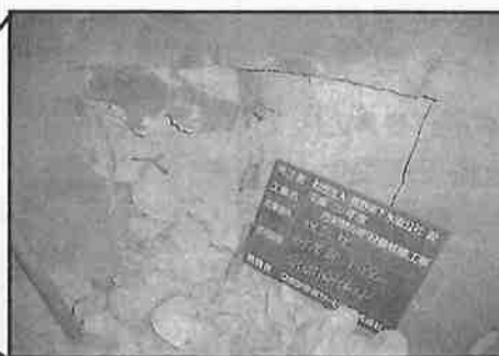
流動焼却炉の炉内剥落状況
