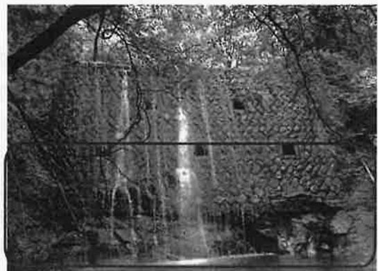
砂防堰堤の基礎洗掘
