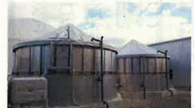
バイオガス発電 中野市
