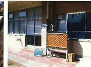
雨水貯留タンク設置例
