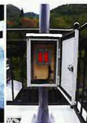
非常用コンセント(右)
