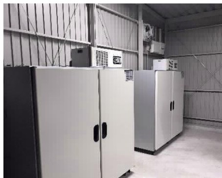
【設置した保管用冷蔵庫2台】
